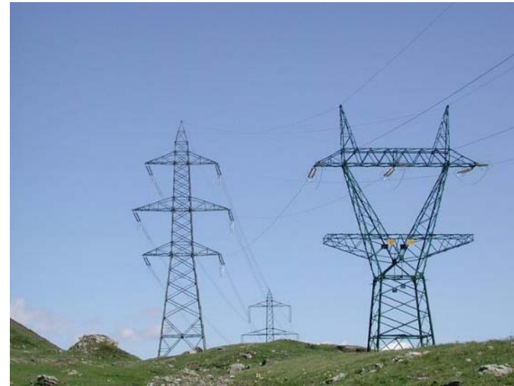
Tralicci per elettrodotti
