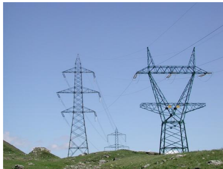
Tralicci per elettrodotti
