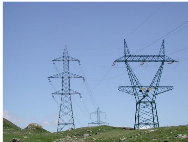
Tralicci per elettrodotti
